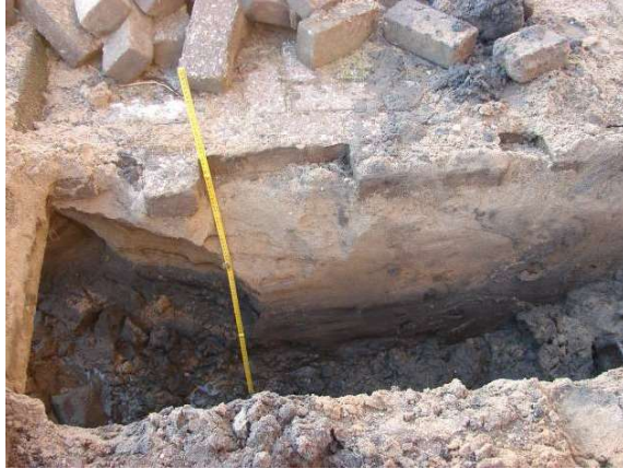
Afb. 2-001.3: zuidprofiel. Links van de meetlat bevindt zich het muurwerk (S1). Te zien is dat de putwand instort. Langs de linkerkant van de foto ligt de stoeprand.
