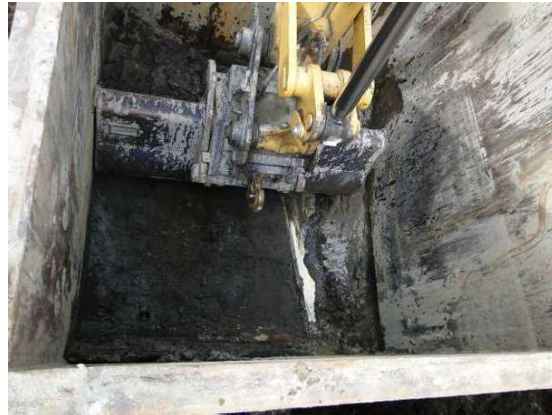
Afb. 1–011.5: vlak 2, liggend hout onder de kademuur.
