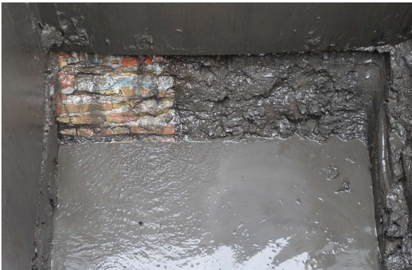
Afbeelding 35: containerlocatie 1–059 Regentesseplantsoen, detail van de steunbeer in de hoek van de containerbak.
