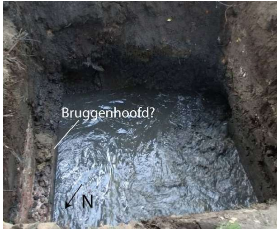
Afb. 1-060.3: toestromend water uit het riool.
